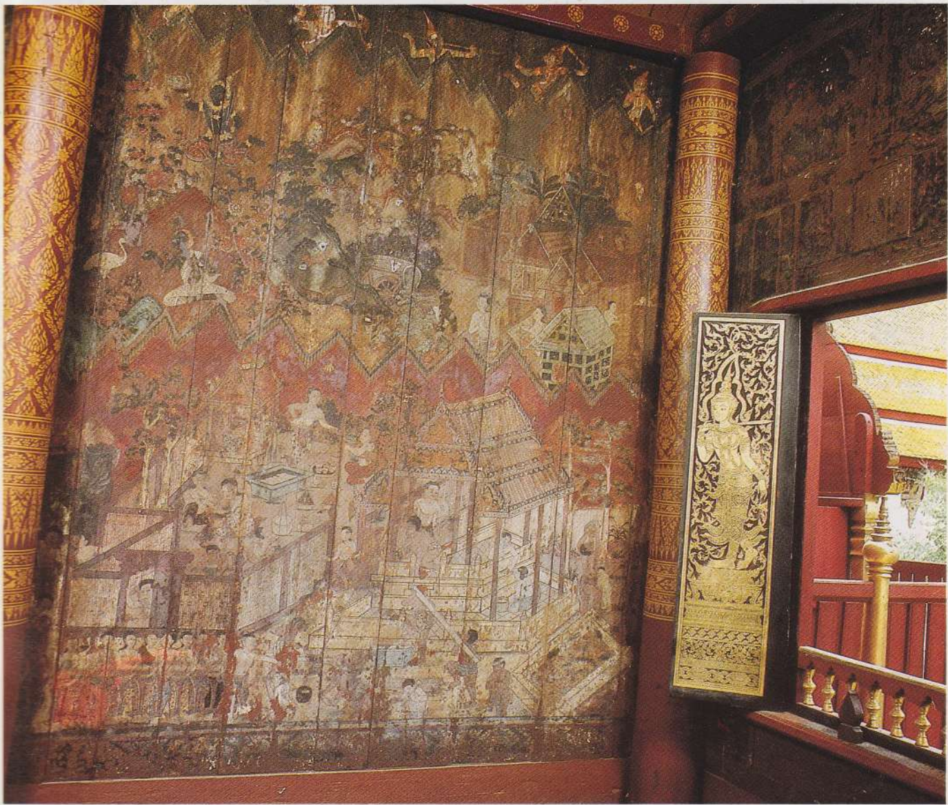
38 ตำนานพระอินทร์ หอพระไตรปิฎก วัดระฆังโฆสิตาราม Conservation of the painting on a wooden panel at the Library of Wat Rakang Kositaram
